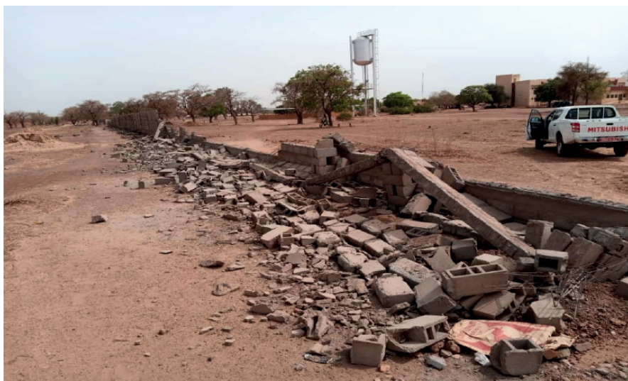
Image 1 : Mur de clôture en construction écroulé
